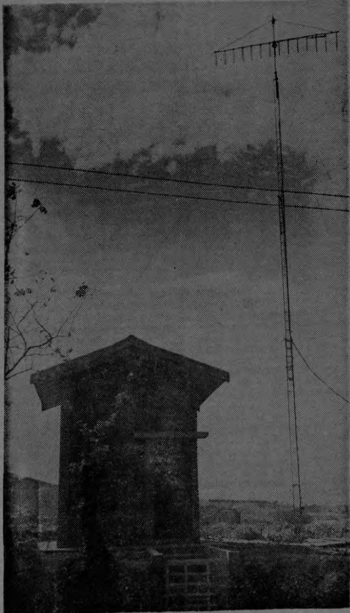
SAN CARLOS CUENTA CON SISTEMA VHF PARA SERVICIO TELEFONICO: El Instituto Costarricense de Electricidad ha instalado un nuevo y moderno equipo de radio-enlace VHF en Ciudad Quesada, lo que permite que el servicio telefónico municipal de esa localidad sea enlazado con la Central Telefónica Automática de Alajuela, ofreciendo así un servicio telefónico semi-automático de y para Ciudad Quesada con el resto del país.
